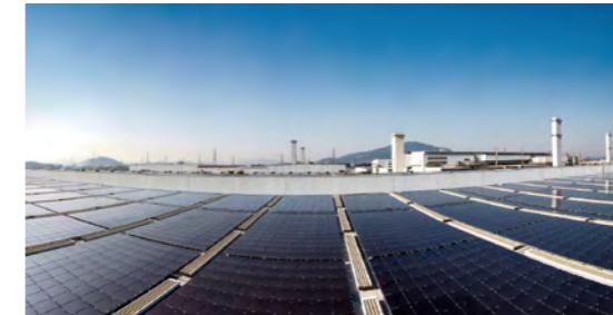
增城工厂光伏发电项目
